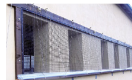
Plachta stažená na spodním parapetu
